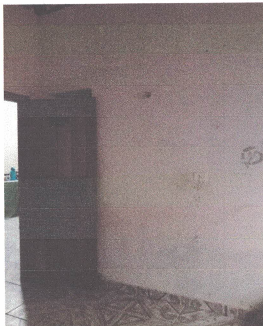
Foto 18: Sala do CME, paredes rebocadas e pintadas na cor areia, com emassamento, apresenta manchas e desbotamento.
