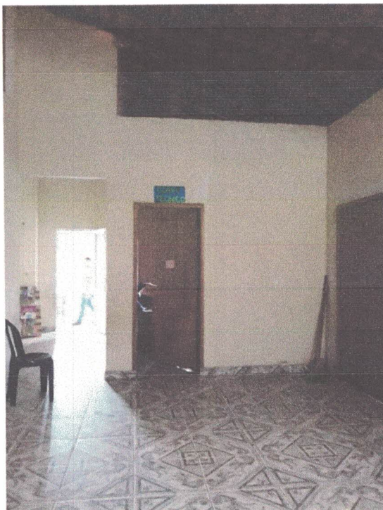
Foto 15: Cozinha, cobertura em estrutura de madeira com telha cerâmica tipo capa/canal colonial.
