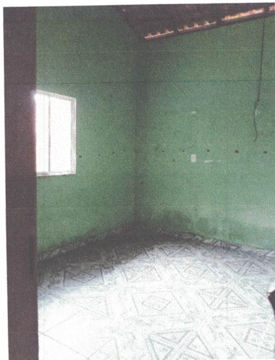
Foto 22: Sala do CAE, piso em revestimento cerâmico estampado, paredes com sinais de umidade ascendente.
