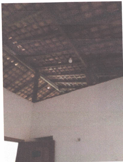
Foto 19: Sala do CME, cobertura em estrutura de madeira com telha cerâmica tipo capa/canal colonial.
