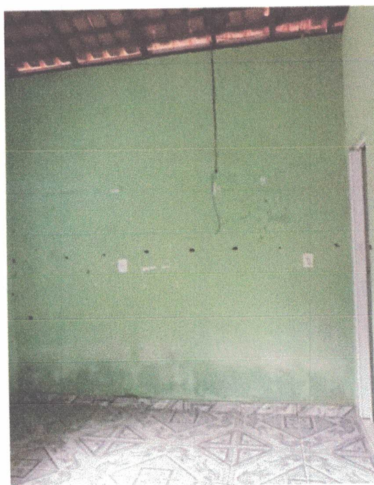
Foto 24: Sala do CAE, cobertura em estrutura de madeira com telha cerâmica tipo capa/canal colonial, parede com tinta desbotada e sinais de infiltração ascendente.
