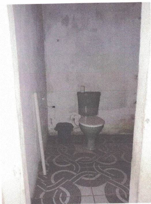
Foto 20: Banheiro Sala do CME, piso em revestimento cerâmico estampado, paredes rebocadas e pintadas, sem emassamento, cobertura em estrutura de madeira com telha cerâmica tipo capa/canal colonial.
