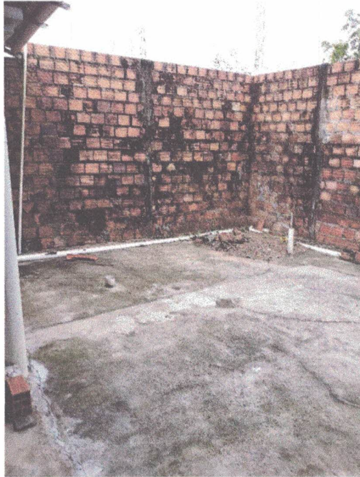
Foto 39: Área livre, localização da fossa, com muro sem revestimento, em alvenaria aparente.
