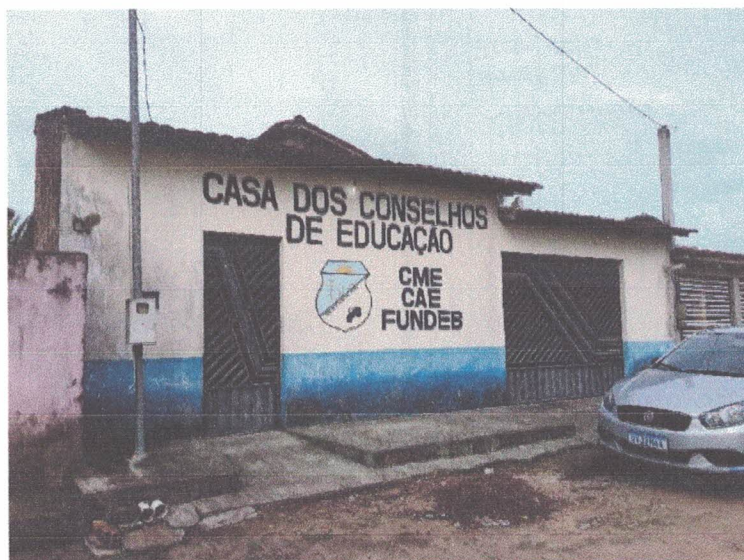
Foto 01: Fachada principal da edificação, calçada em concreto, paredes rebocadas e pintadas com sinais de infiltração e necessidade de pintura, portão em ferro.
