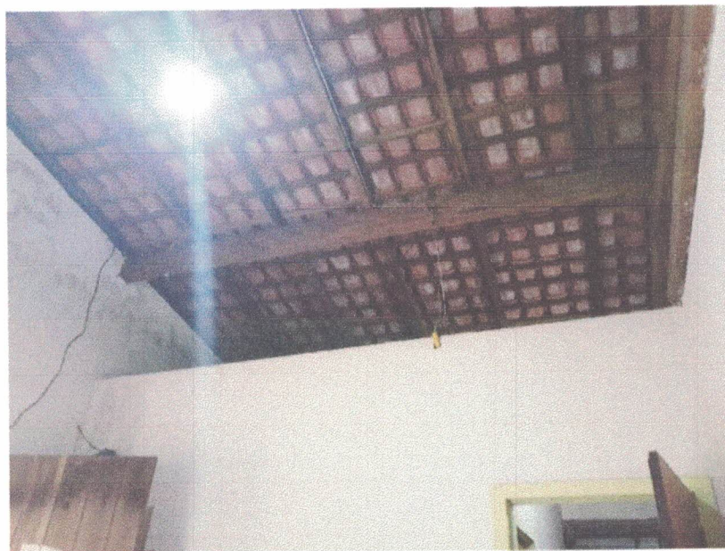
Foto 41: Sala Endemias, sem forro, cobertura em estrutura de madeira e telhas cerâmicas tipo capa/canal colonial.
