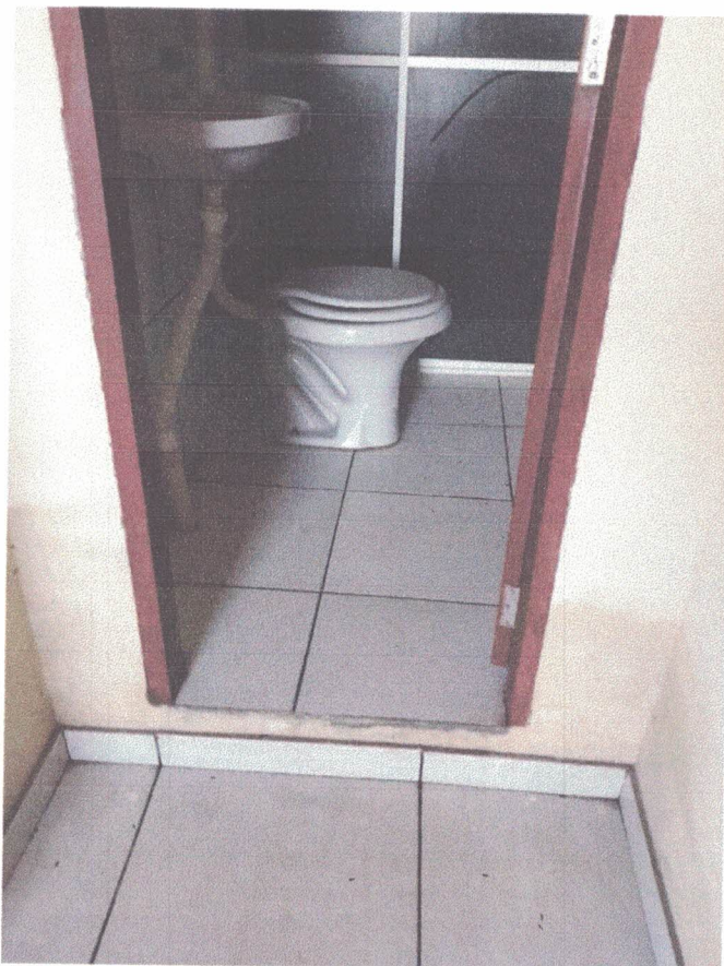
Foto 61: Pavimento superior – banheiro, piso cerâmico na cor bege, paredes rebocadas emassadas e pintadas na cor salmão, com sinais de umidade ascendente.
