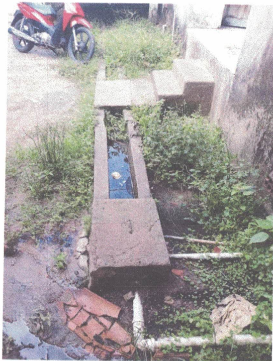
Foto 46: Tubulação exposta, acúmulo de água, caixas de drenagem e necessidade de remoção de vegetação.
