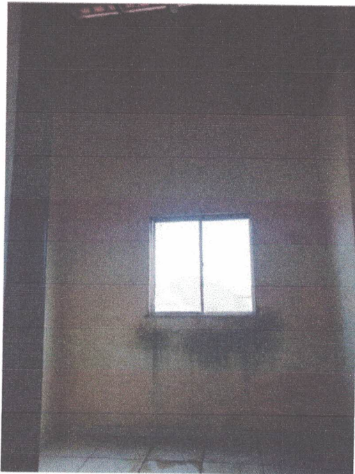
Foto 59: Pavimento superior – dormitório 02, piso cerâmico na cor bege, paredes rebocadas emassadas e pintadas na cor salmão, sinais de infiltração e acúmulo de matéria orgânica na base da janela.
