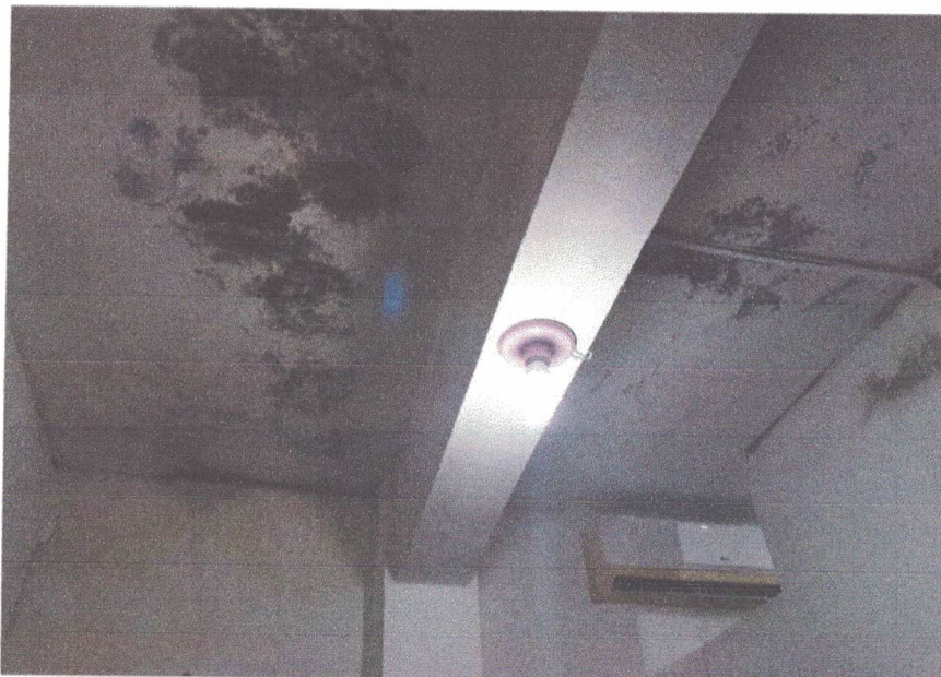
Foto 12: Sala TFD, laje de concreto rebocada, emassada e pintada na cor branca, com sinais de infiltração.
