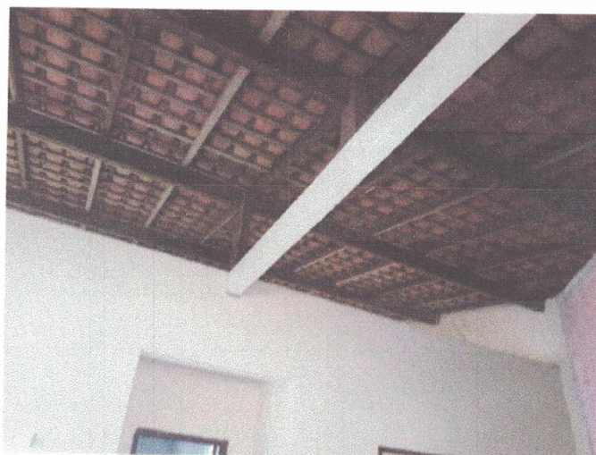
Foto 62: Pavimento superior - Sala 02, piso cerâmico na cor bege, paredes rebocadas emassadas e pintadas na cor salmão.
