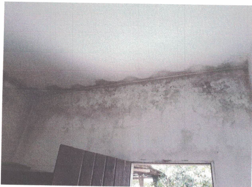
Foto 26: Cozinha, laje em concreto rebocada e pintada na cor branca, parede e laje com sinais de infiltração.
